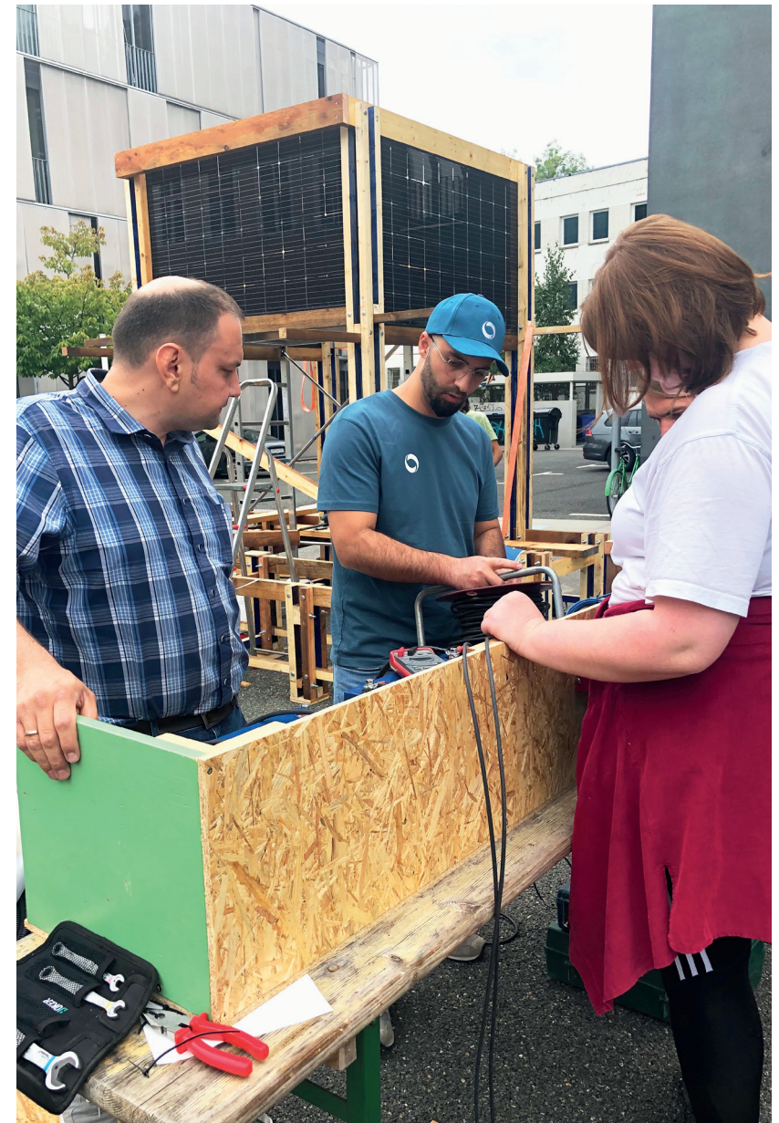
Experten von Solarwatt unterstützen die Installation der Anlage Experts from Solarwatt support the installation of the system
